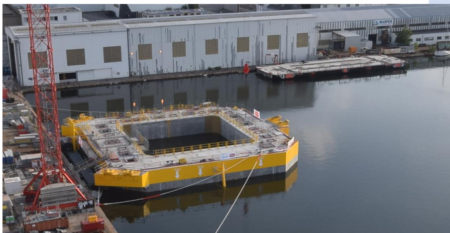
La fondation flottante à quai, après sa mise en flottaison ©Ideol/Bouygues Travaux Publics
